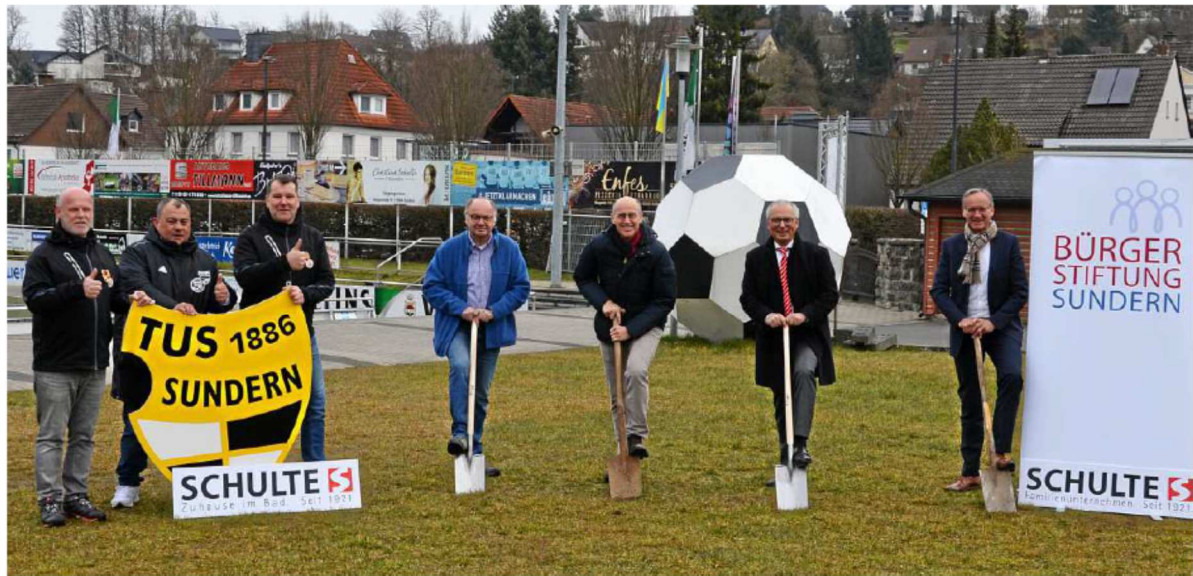
Spatenstich beim TuS Sundern für den neuen Spielecourt: Die Werkzeuge betätigen die Hauptsponsoren Wolfgang Hilgenroth (Hilgenroth Tiefbau), Joachim Schulte (Schulte Duschkabinen), Ernst-Michael Sittig (Sparkasse) und Matthias Müller (Bürgerstiftung Sundern), links daneben die TuS-Vertreter Fußballabteilungsleiter Andreas Mühle, Jugendabteilungsleiter Paolo Brunetti und Vorsitzender Eric Wachholz. FOTO: MATTHIAS SCHÄFER
